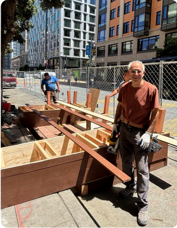
Jeff Miller y su equipo comienzan la construcción del parklet frente al 111 Jones.
